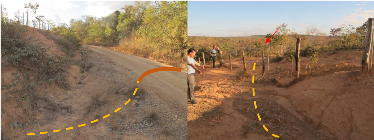
Foto 3: Processo erosivo a ser disciplinado com construção de lombada, bigode e barraginha (Coord. UTM 552200 / 7931147).
